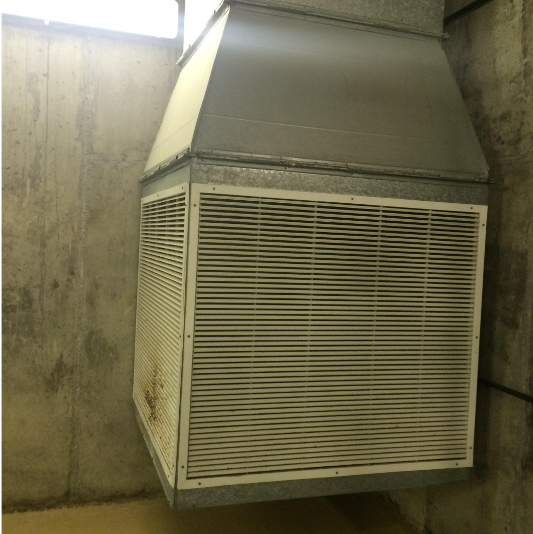
Dry Pit Exhaust Fan (F-1)
