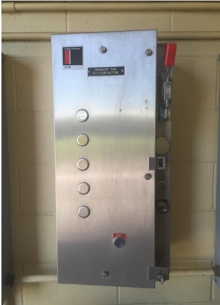
Exhaust Fan Control Panel
