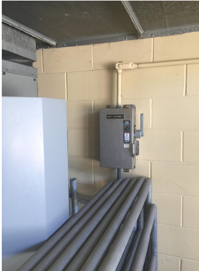
Exhaust Fan F-1 Disconnect
