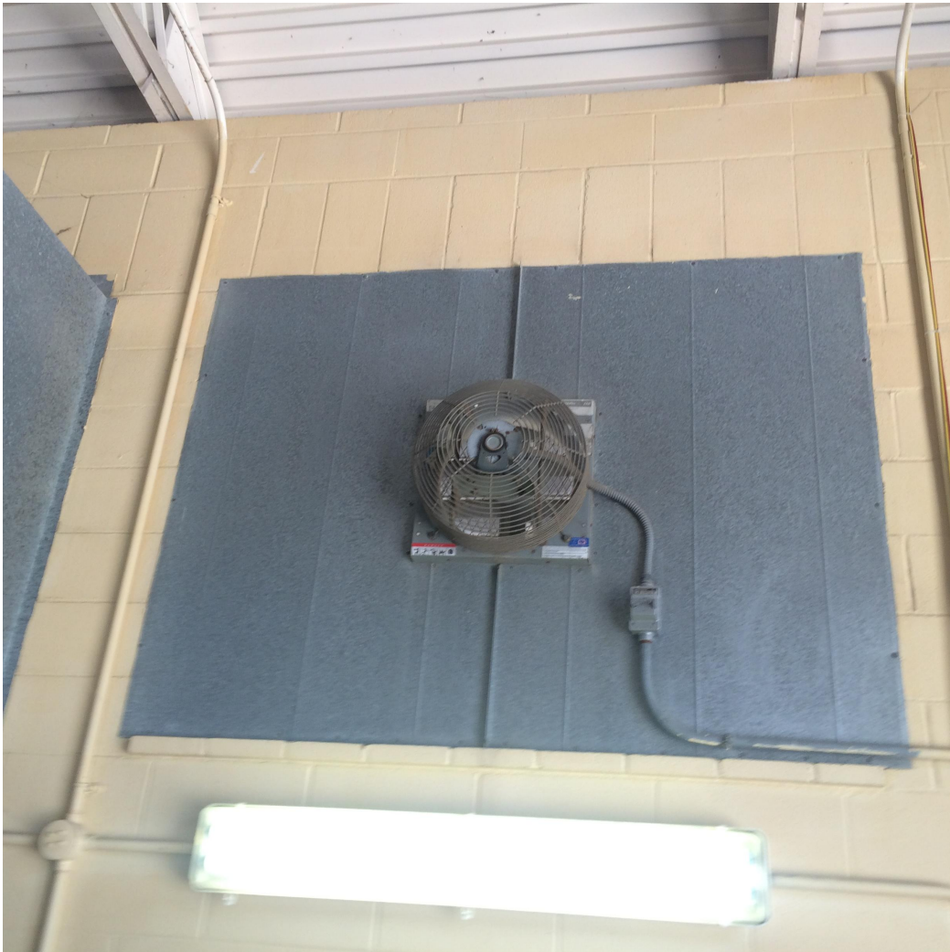
Control Room Wall Exhaust Fan (F-2)
