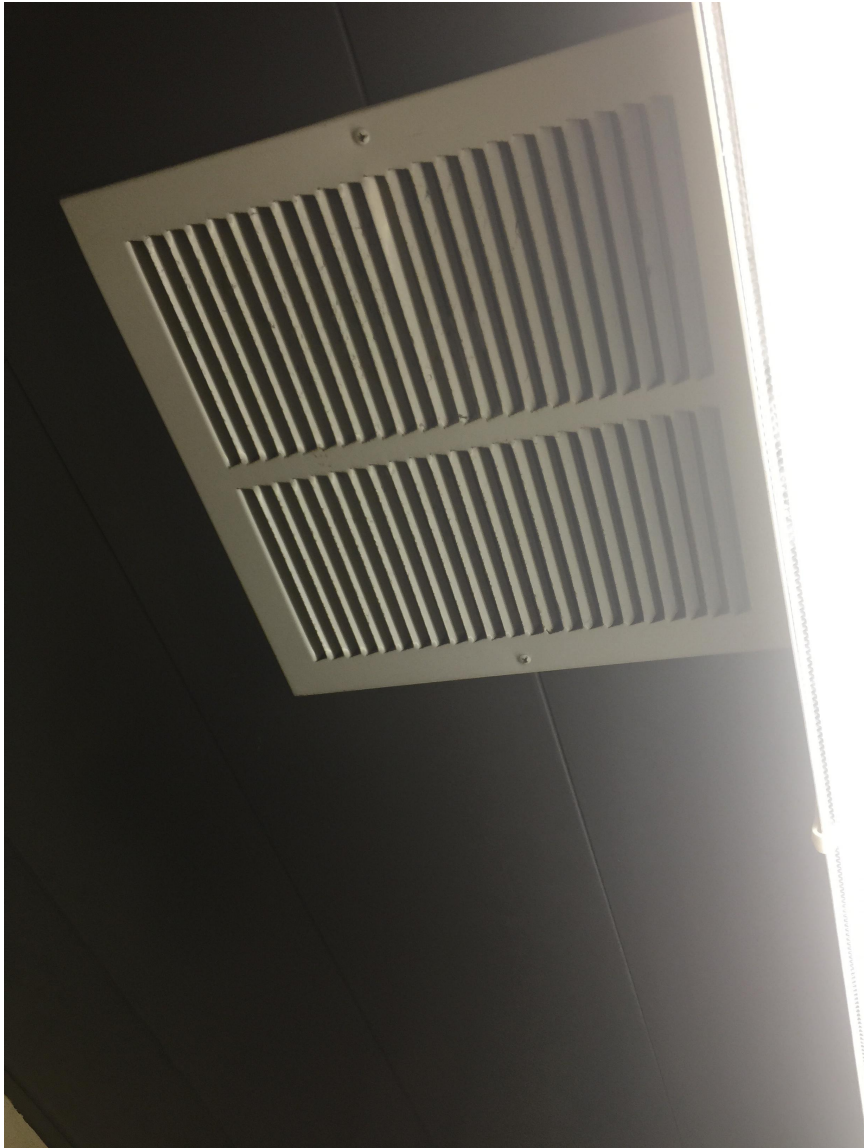
Exhaust Fan (F-4)
